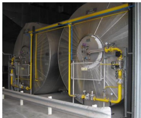
INSTALACIÓN PARA LA ELIMINACIÓN DE COVS
