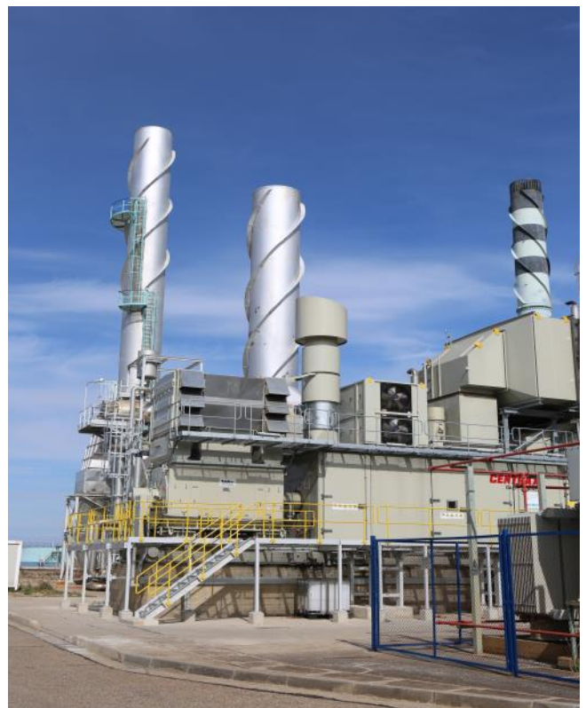
PLANTA DE ENERGÍA
