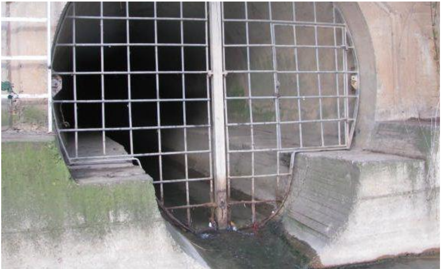
SALIDA DE AGUAS POR EL EMISARIO AL RIO JALÓN
